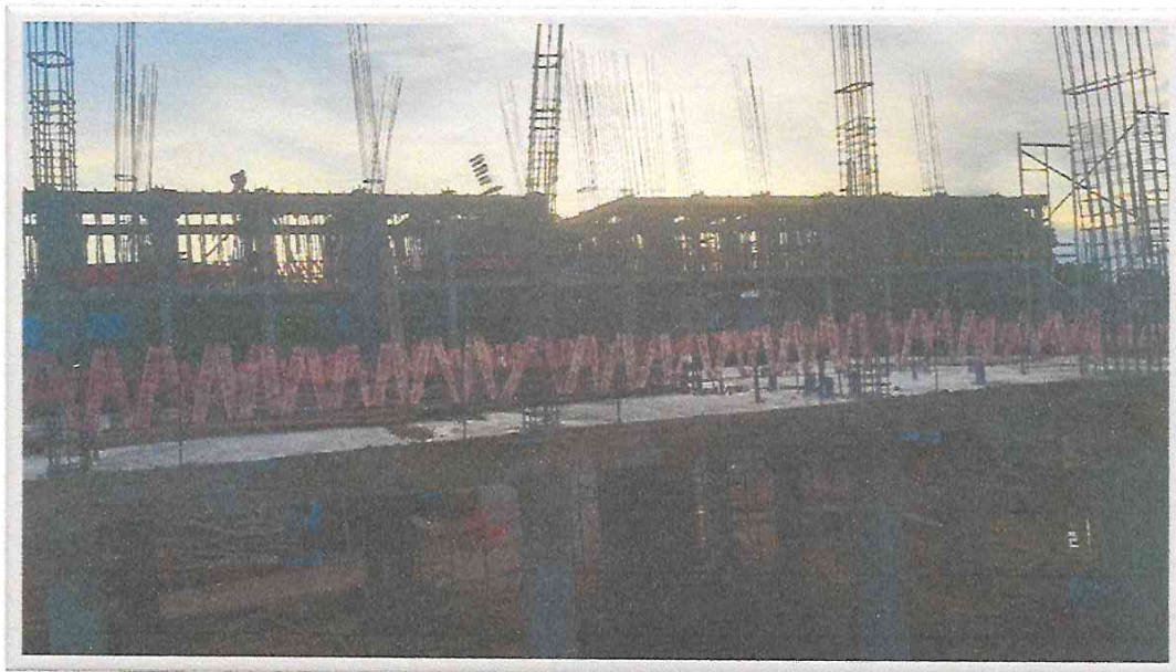
VISTA DE COLOCACION DE COLUMNAS DE ACERO CORRUGADO EN 2° PISO DE MOD "D".
