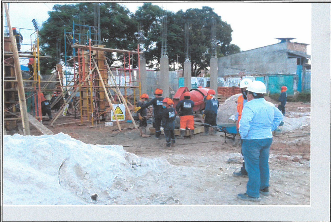
VISTA DE RESIDENTE EN TRABAJOS DE VACIADO DE MORTERO DE COLUMNAS EN BLOQUE
