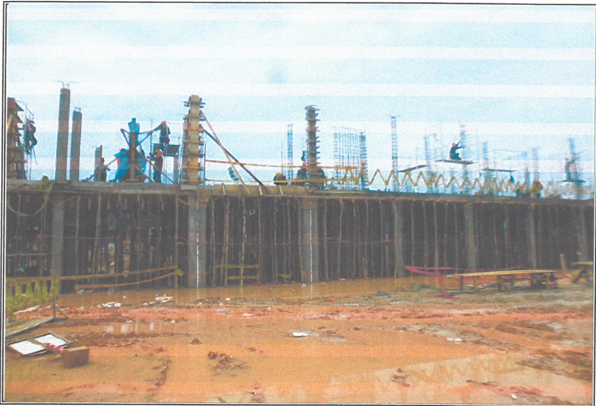
VISTA DE VACIADO Y ENCOFRADO DE COLUMNAS DE MODULO D DEL 2° PISO
