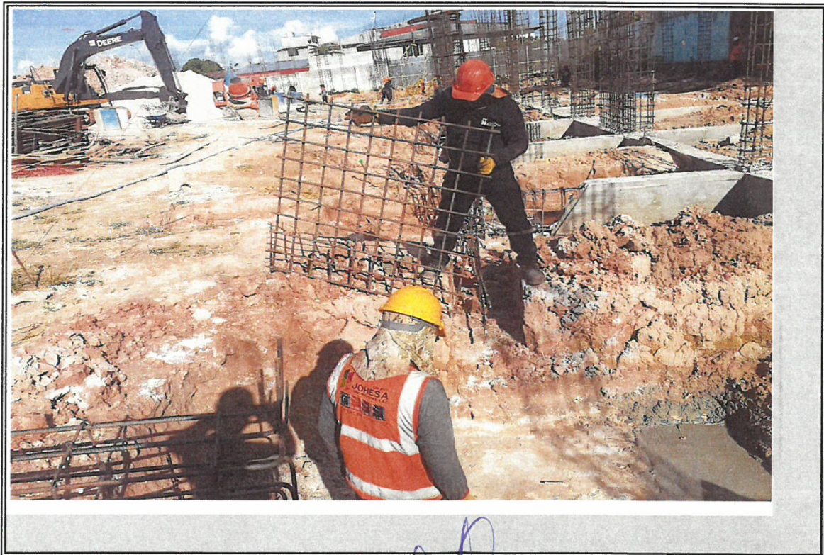
GRUPO JOHESA CONSTRUCTORES S.A.C. COLOCADO DE PARRILLA DE ACERO EN ZAPATAS DE MODULO B
