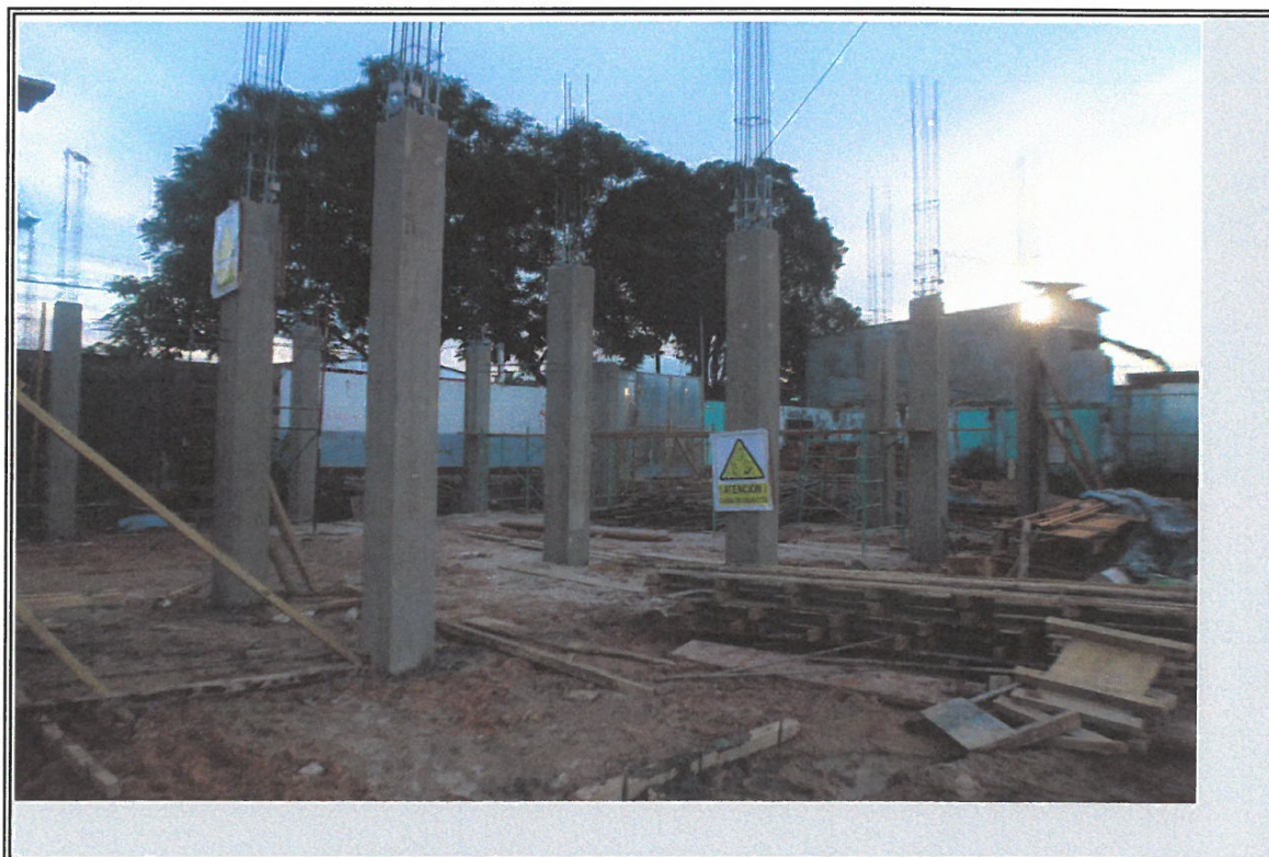
VISTA DE VACIADO DE MORTERO DE COLUMNAS DE BLOQUE B GRUPO JOHESA CONSTRUCTORES S.A.C. SAUL YANGARI CARTOLIN GERENTE GENERAL
